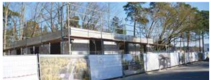
Gegenüber dem Neuen Atelierhaus Panzerhalle wächst der Cafébau am Eingang zur Waldsiedlung in die Höhe. Früher stand hier das Trafohäuschen.
