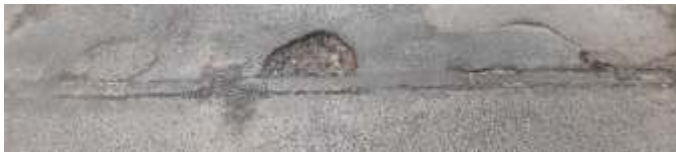
Am Ende des Winters: Reparaturbedarf an Dünnschichtdecken
