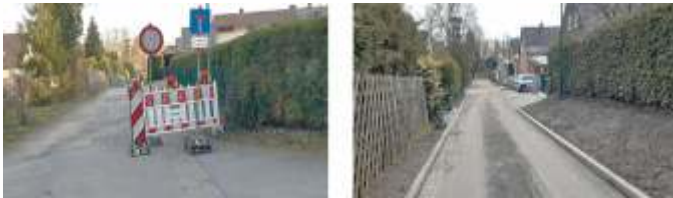
Das Foto links habe ich im März 2022 aufgenommen: die Bauarbeiten hatten gerade begonnen. Das Foto rechts genau ein Jahr später, im März 2023: die Straße Alter Weinberg ist gerade fertig geworden.
